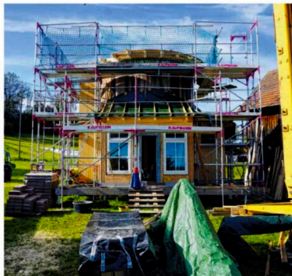
Wer genau hinsieht, erkennt, dass dies kein gewöhnliches Haus ist. Es wurde unter anderem aus einem alten Holzsilos gefertigt.
